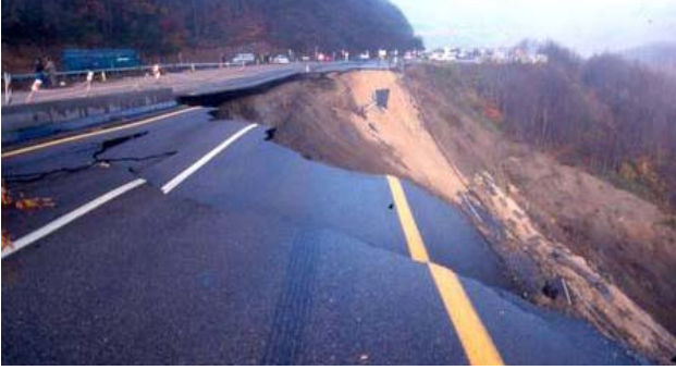
Şekil 2. E-5 karayolu Bolu Dağı geçişinde toprak kayması-12 Kasım 1999 Düzce depremi (Adapazarı Büyükşehir Belediyesi Arşivi)
