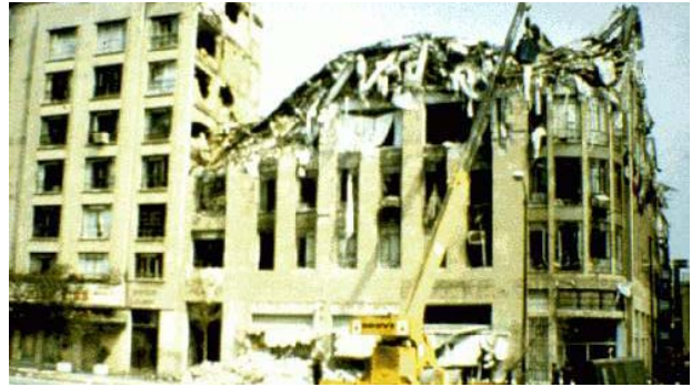
Şekil 4. Rezonans sebebiyle hasar gören yapı-Mexico City (www.johnmartin.com)
