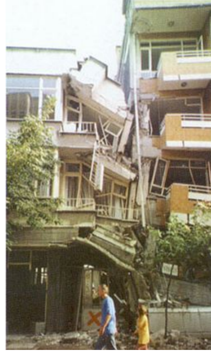
Şekil 15. Farklı yükseklikteki bitişik yapıların çarpışması-Gölcük, 1999 (Pampal, 2000)
