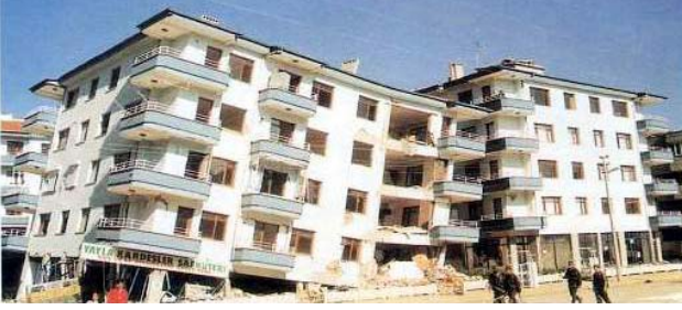
Şekil 10. Yumuşak kat oluşumu ile zemin katın göçmesi (Başbakanlık internet sitesi)
