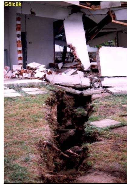
Şekil 1. Gölcük’te yüzey kırığı üzerinde bir bina (Bekirpaşa Belediyesi Arşivi)
